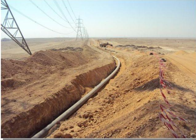
المصدر: من واقع الدراسة الميدانية للباحث، شهر إبريل عام ٢٠١٧م. صورة (٢) مد خط انابيب نقل النفط للمحطة العاشرة لتوليد الكهرباء.
