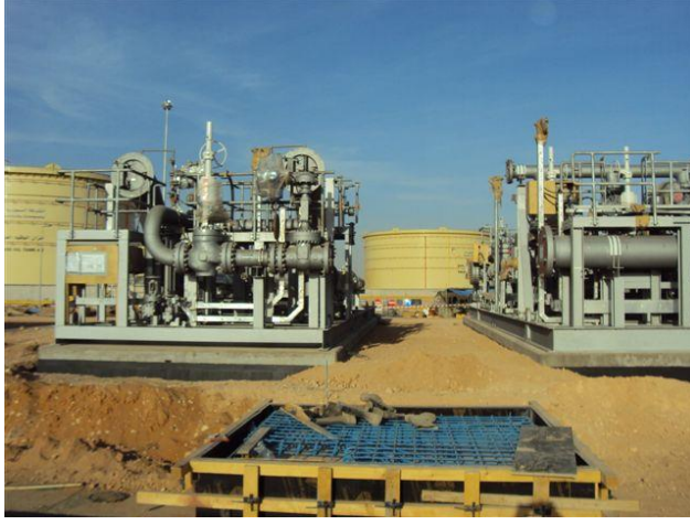
المصدر: من واقع الدراسة الميدانية للباحث، شهر إبريل عام ٢٠١٧م. صورة (١) وحدات تفرغ وضخ الوقود في المحطة العاشرة لتوليد الكهرباء عام ٢٠١٧م.
